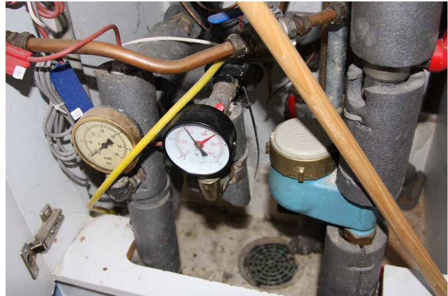
Rørføring i teknikskab
