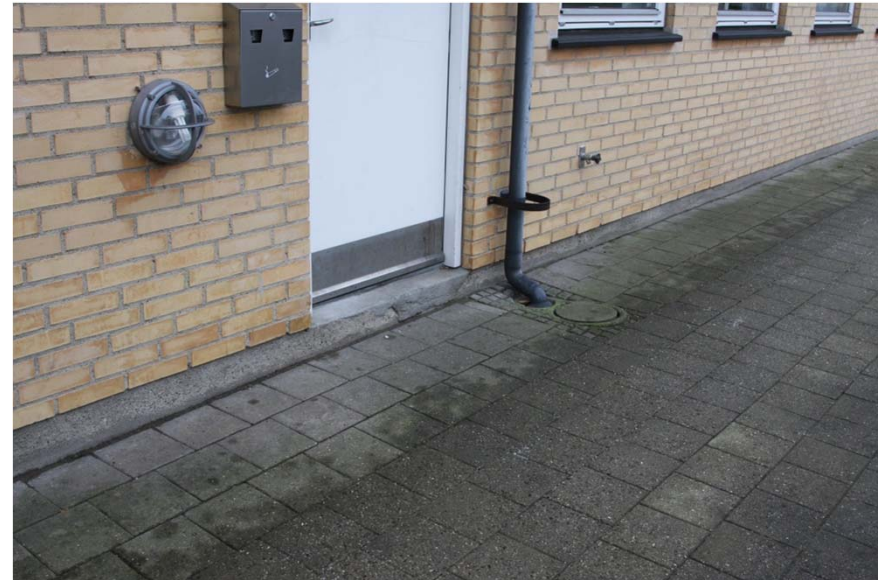
Sokkel med skader (Fælleshus)
