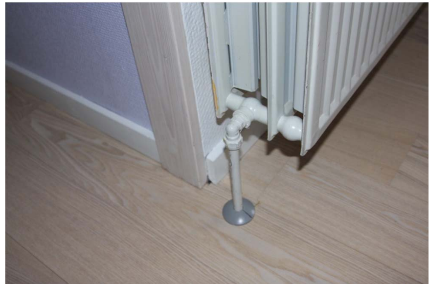
Varmerør unde gulv
