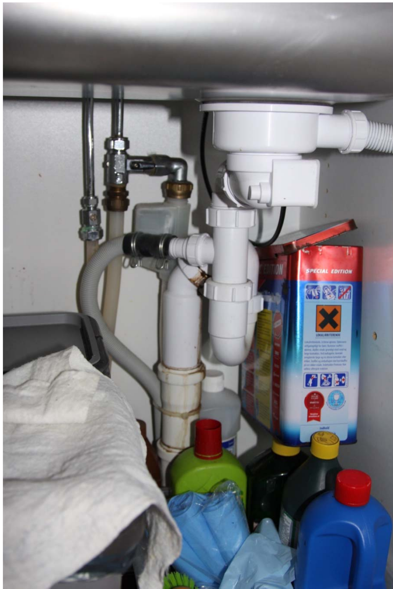
Afløb og vand under køkkenvask
