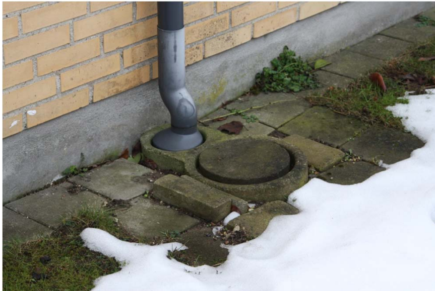
Belægning er sunket
