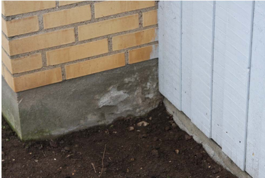
Sokkelpuds under nedbrydning
