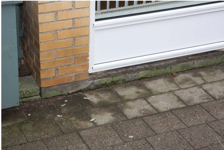
Sokkel under nedbrydning (fælleshus)
