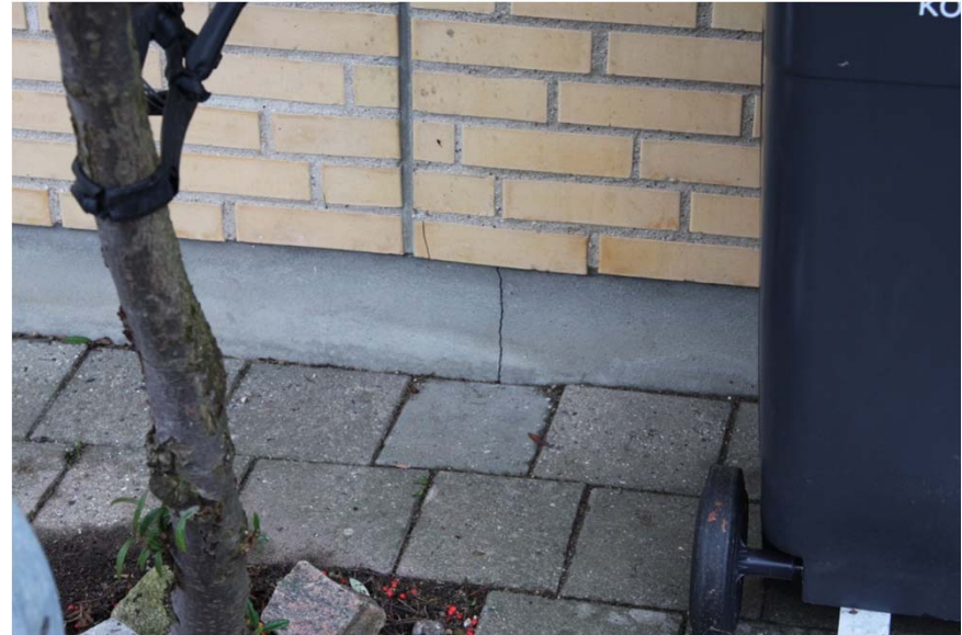
Revne i sokkel
