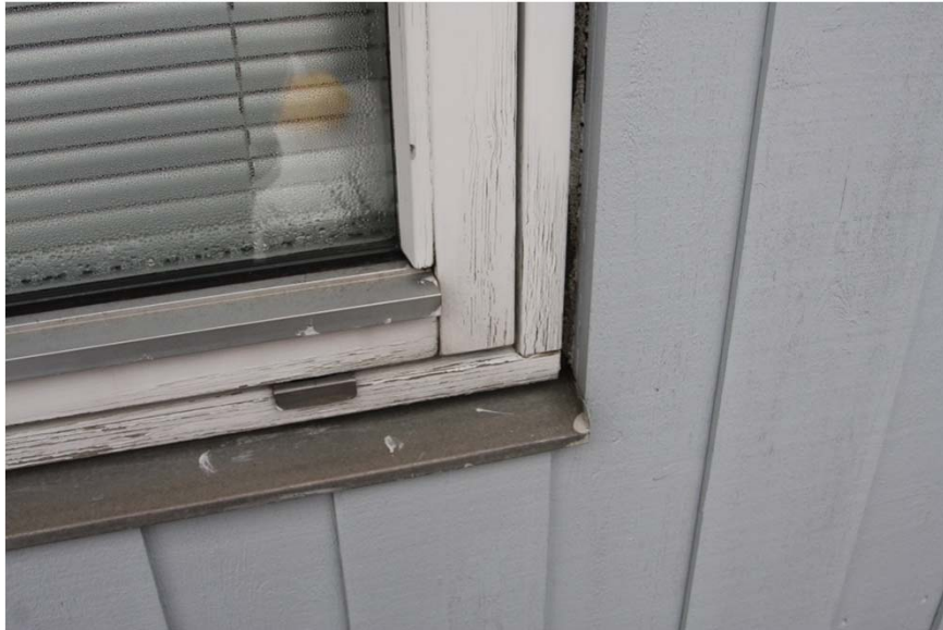
Trævindue med begyndende nedbrydning
