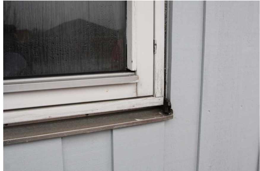
Malingslag under nedbrydning
