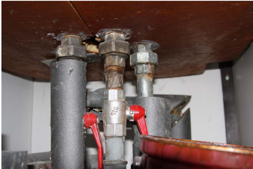
Rørføring under beholder
