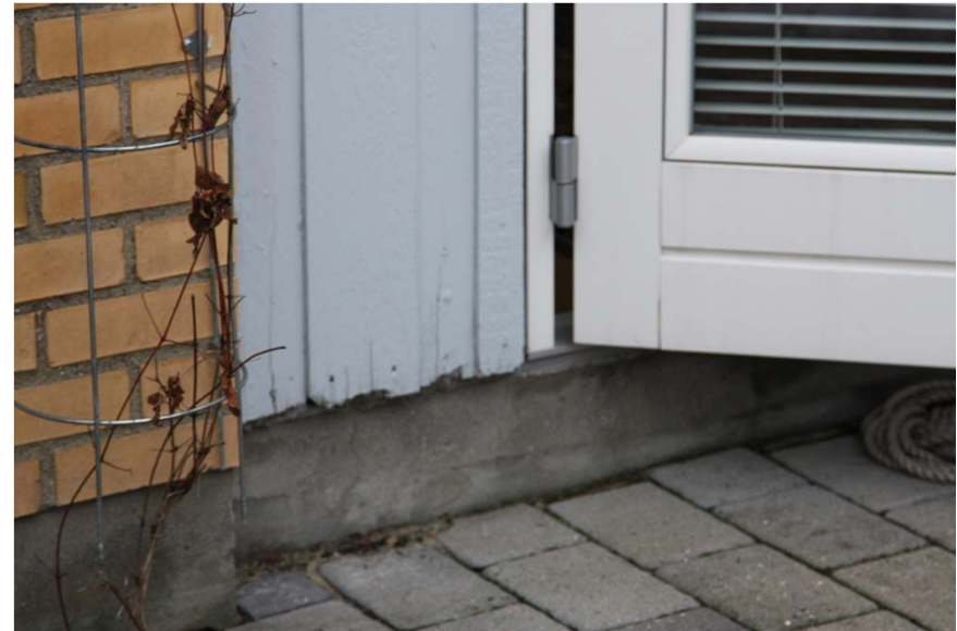
Træfacade under nedbrydning
